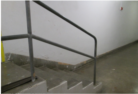
Non ADA complaint stairs
