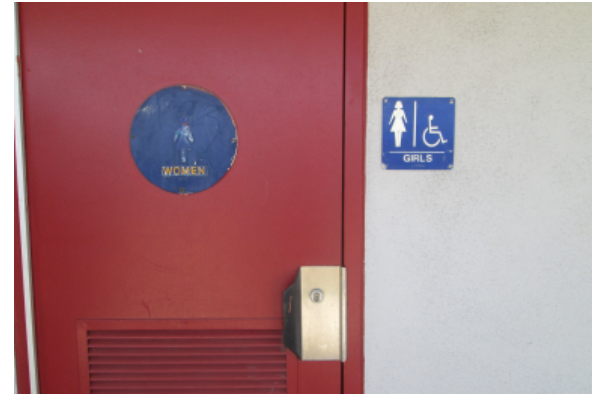
Door signage deteriorating
