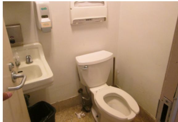
Non ADA compliant restroom
